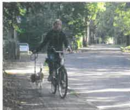
Schlechter Zustand der Nebenanlagen
